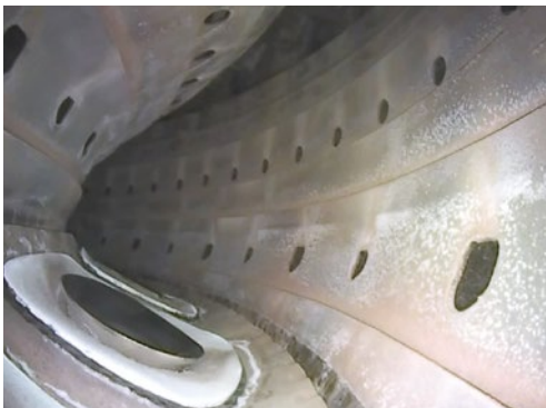
Cámara de combustión
